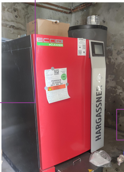
Chaudière à bois
